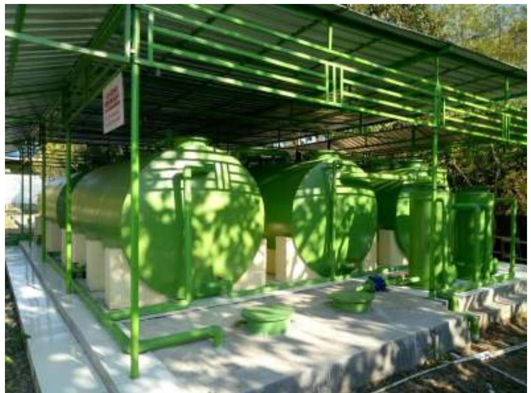
Gambar 3. 7 Instalasi Pengolahan Air Limbah (IPAL) RSUD Temanggung
